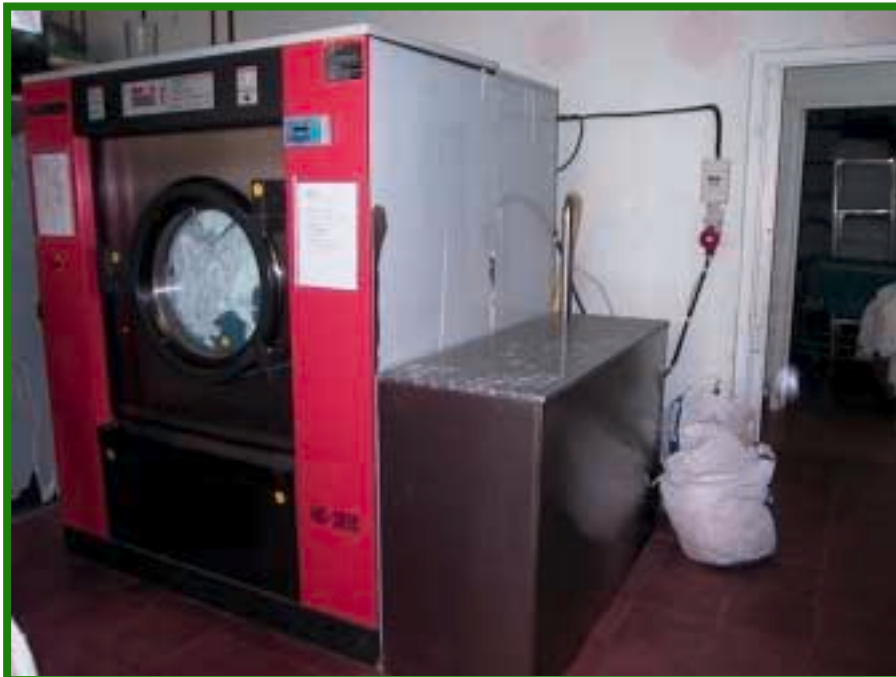
Lavadora que recircula el agua del aclarado para el prelavado, con el consiguiente ahorro y eficiencia.
