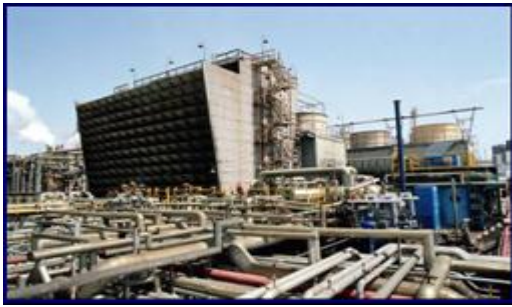
Figura 11: Torre de Refrigeración.
