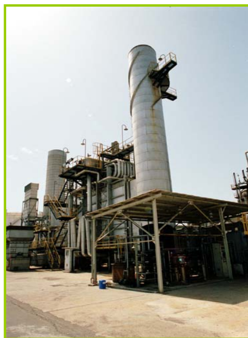
Figura 12: Turbina de cogeneración.
