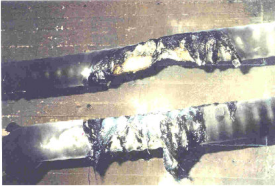
Figure 17: Endommagement de câble lors de l'essai de court circuit en configuration en courant alternatif
