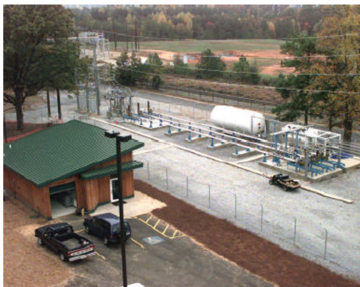
Figure A30: première installation mondiale d'un câble triphasé SHT dans une installation industrielle (Southwire)
