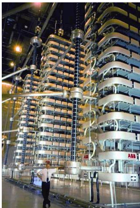
Figure A5 : convertisseur en pont dodécaphasé dans un poste HVDC
