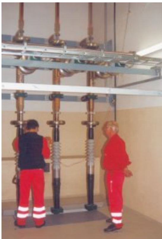
Figure A31: bornes terminales des câbles de distribution SHT installés au Danemark
