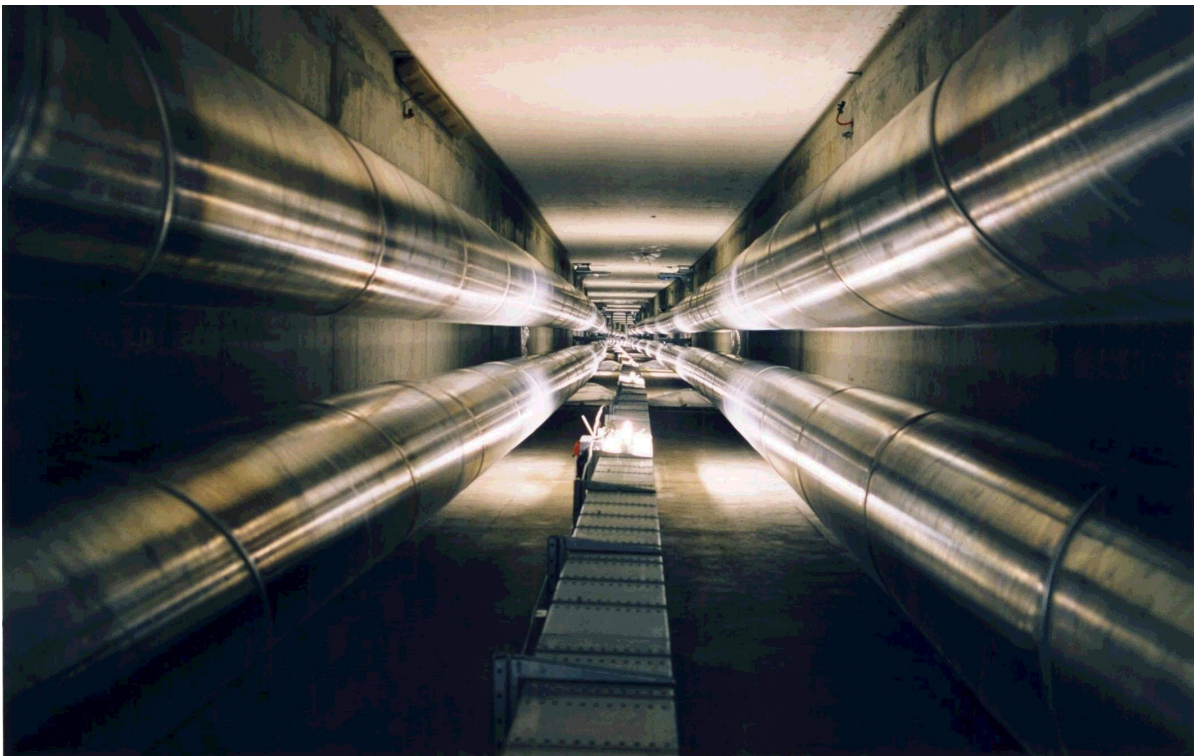
Figure A19: tunnel contenant les câbles à isolation gazeuse à Genève
