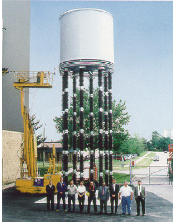
Figure A6 Réactance isolée en air 150mH, 500kV, 1800 A
