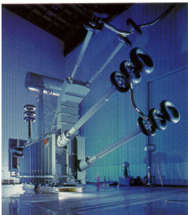
Figure A3 exemple de transformateur de conversion
