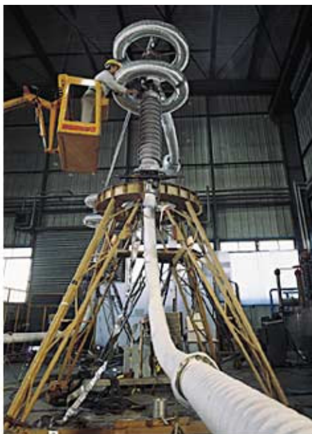
Figure A29: Borne terminale du câble Pirelli 115 kV en phase d'essais
