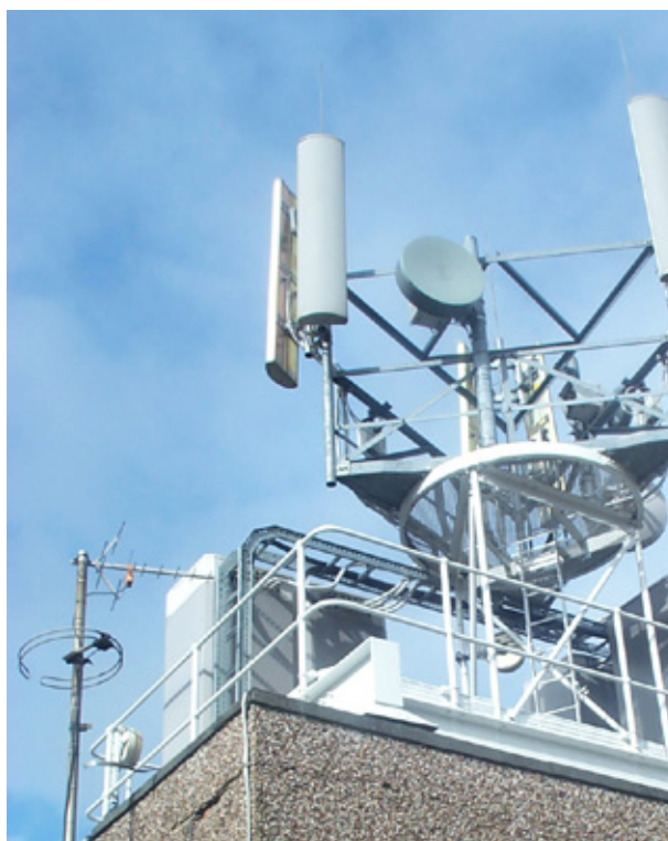
Obrázok 10.1 Sektorové antény pre mobilné telefóny a mikrovlnný tanier na streche výťahovej strojovne
