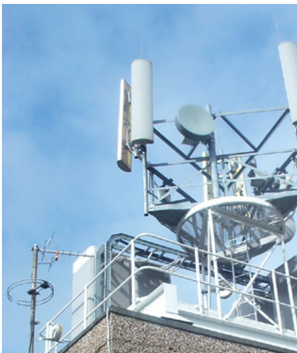
Figura 10.1. – Antene sectoriale de telefonie mobilă și o antenă parabolică montate pe acoperișul clădirii
