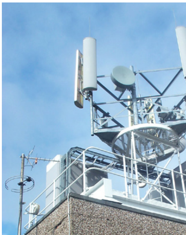
Rysunek 10.1 – Anteny sektorowe telefonii komórkowej i miska antena mikrofalowa umieszczone na dachu pomieszczenia dźwigowego
