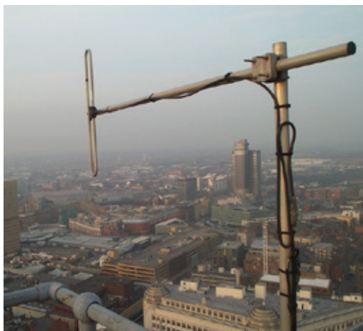
a) Antenne du système de radiomessagerie trop proche de la passerelle
