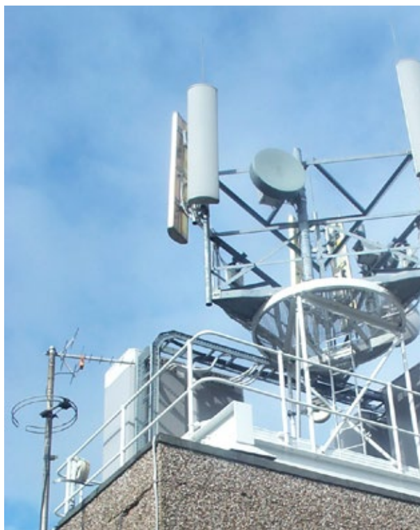
Figur 10.1. Sektoropdelte mobiltelefonantennener og parabolantenne på taget af elevatorhus
