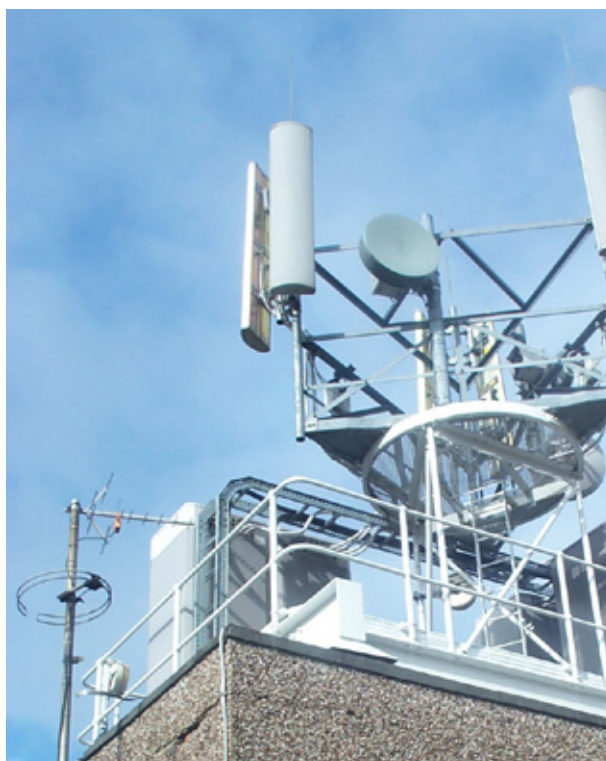
Obrázek 10.1 Sektorové antény mobilního operátora a mikrovlnná parabolická anténa na střeše výtahové strojovny
