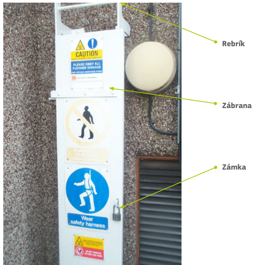
Obrázok 9.2 Použitie zábran na rebríku na obmedzenie prístupu k silným poliam na streche
