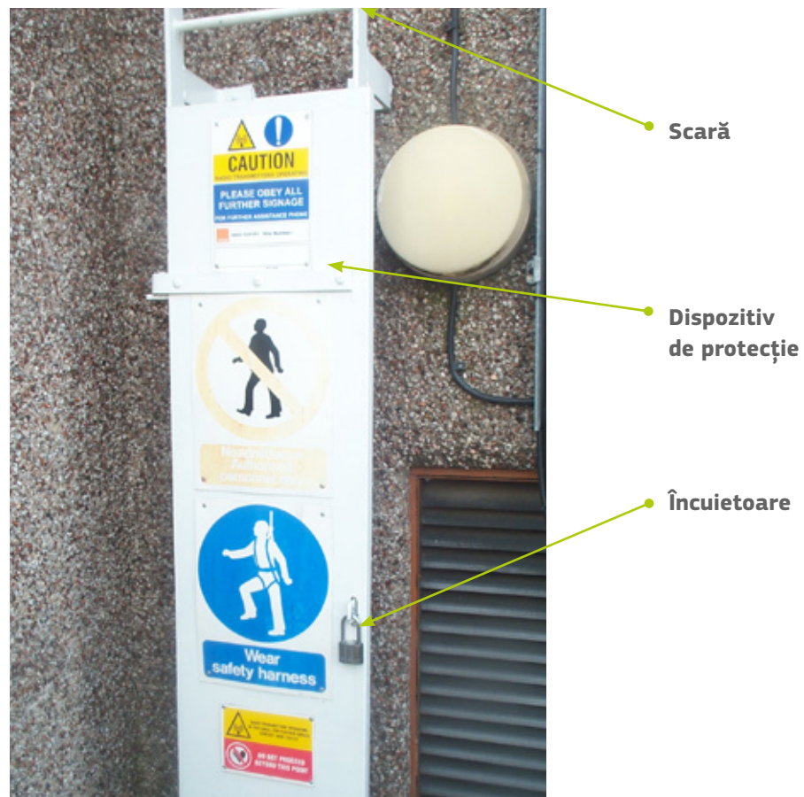
Figura 9.2. – Utilizarea dispozitivelor de protecție pentru scară în vederea restricționării accesului la câmpuri puternice pe un acoperiș
