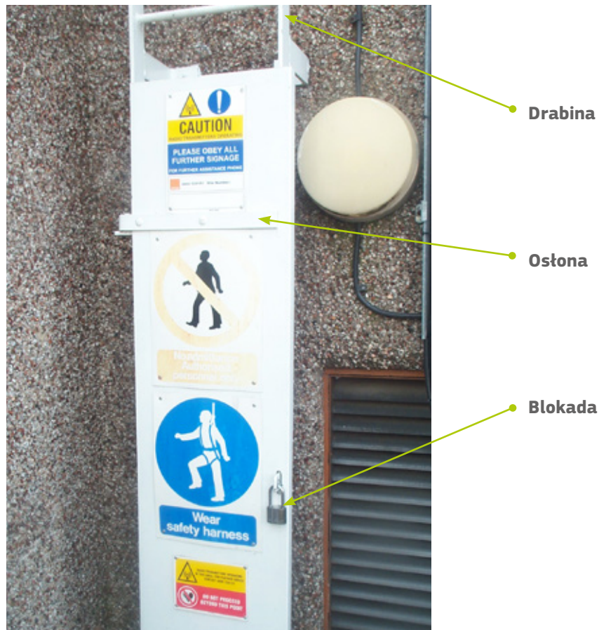
Rysunek 9.2 – Wykorzystanie zabezpieczenia drabiny w celu ograniczenia dostępu do silnych pól na dachu
