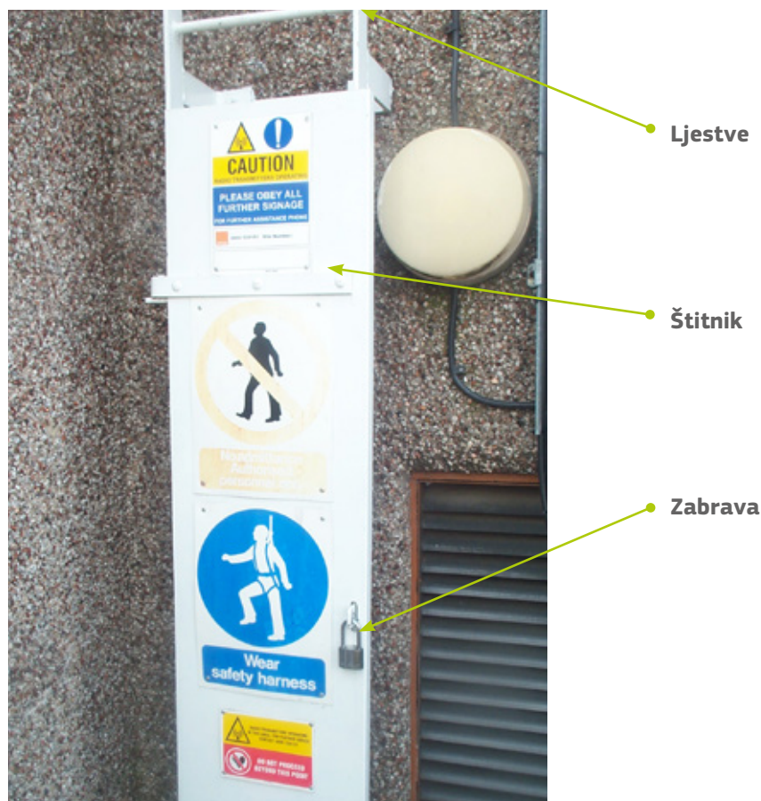
Slika 9.2. – Upotreba štitnika za ljestve da se ograniči pristup jakim poljima na krovu
