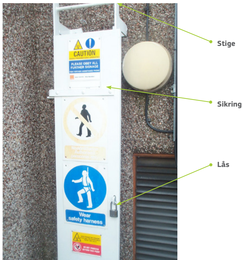
Figur 9.2. Brug af stigesikring til at forhindre adgang til stærke felter på tag
