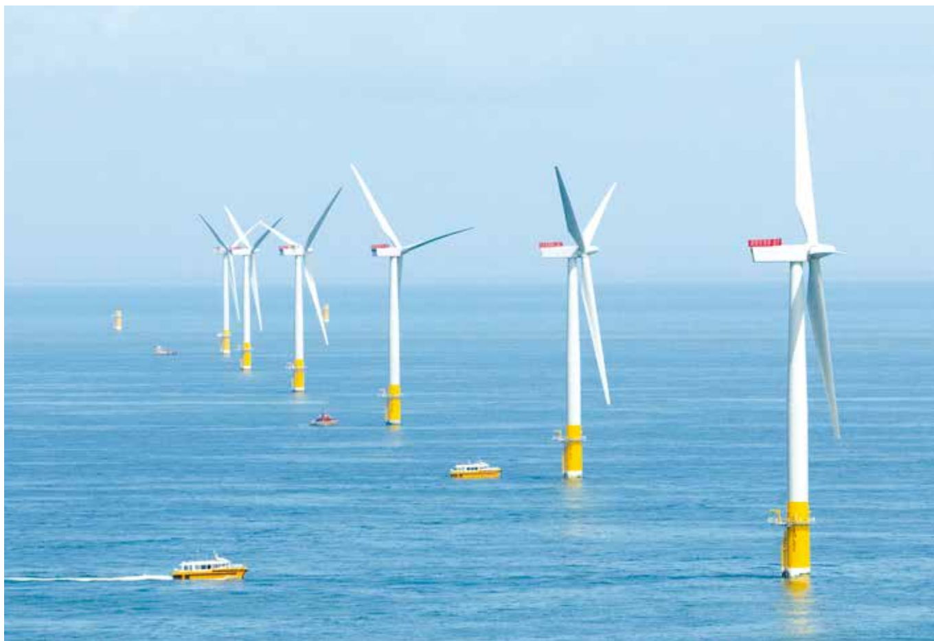
▶Proiectul Galloper este o extindere a fermei eoliene offshore Greater Gabbard prin instalarea a 56 de turbine (UK).
