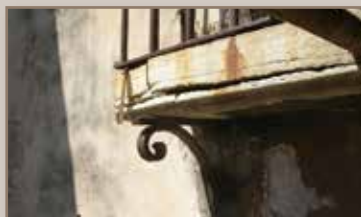
Detalhes da varanda deteriorada
