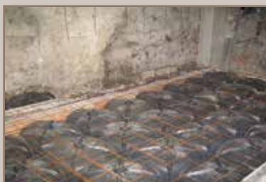
Base de aislamiento
