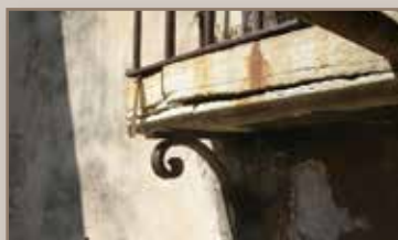
Dettagli del balcone deteriorato
