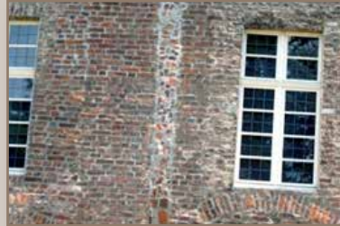
Reparierter Riss in der Fassade
