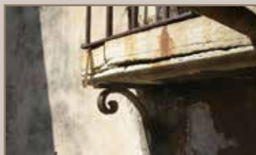
Detalle de balcón deteriorado
