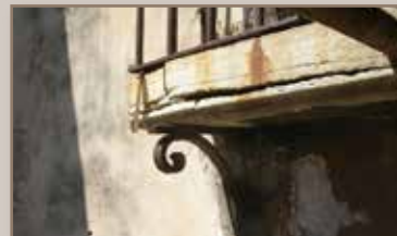
Details des verfallenen Balkons
