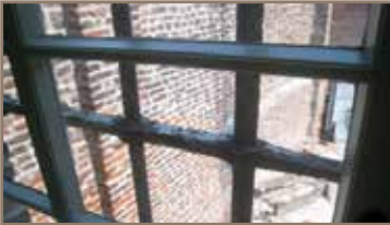
Metalurgía (verjas de las ventanas de hierro) y pintura (marco de madera de la ventana)
