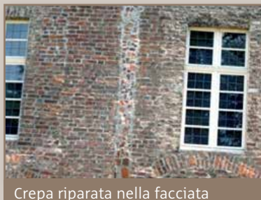
Crepa riparata nella facciata
