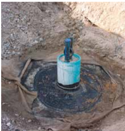
1 Um dos 11 piezómetros duplos para monitorização das características das águas na zona de influência basal da Barragem Velha
