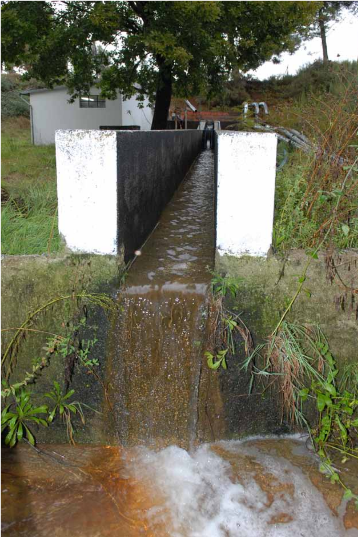
Descarga do efluente, após tratamento, na Ribeira da Pantanha (Urgeiriça)
