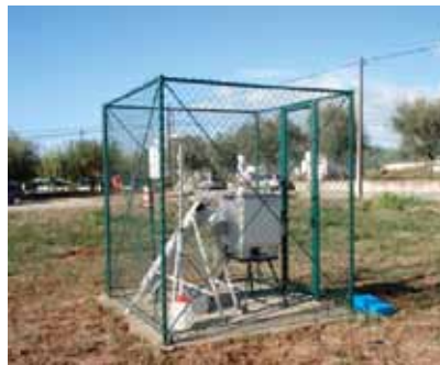
Amostrador de alto volume de partículas PM10, por aspiração do ar, filtragem e depósito de metais Equipamento tipo utilizado para medição na Urgeiriça)
