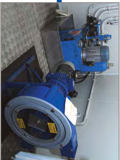
Pompa peristaltica per il campionamento delle acque reflue, sullo sfondo la centralina oleodinamica per la movimentazione della paratoia di adduzione ai depuratore (Foto: Nicola Bazzurro – Iride Acqua Gas)
