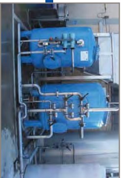
Il prototipo installato a Fin Mode Srl – Particolare dell'impianto di ossidazione chimica con ozono
