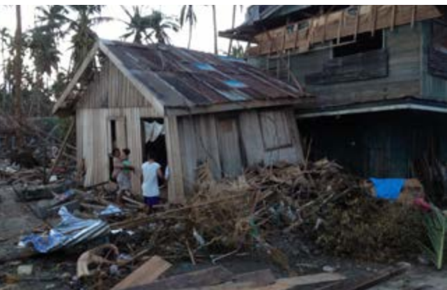
Aux Philippines, les cyclones et typhons sont si fréquents que les dommages structurels comme celui-ci doivent être réparés avant l'arrivée du prochain typhon. © CE / DG ECHO / Bernard Jaspers Faijer
