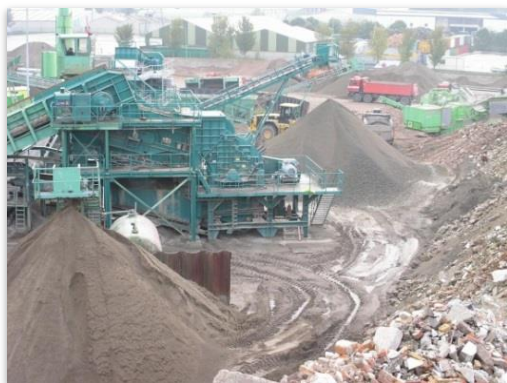
Instalație de reciclare a deșeurilor din construcții și demolări, Sursă: FIR
