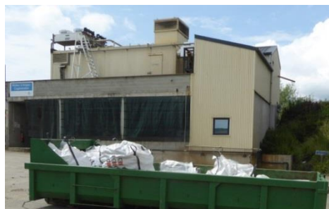
Zbiornik na odpady azbestowe, źródło: A2Conseils sprl.
