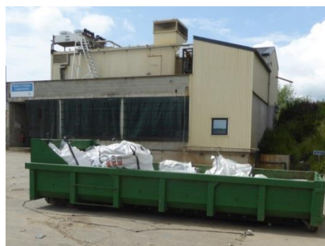
Container met asbestafval, Bron: A2Conseils sprl
