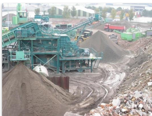
Postrojenje za recikliranje građevinskog otpada
