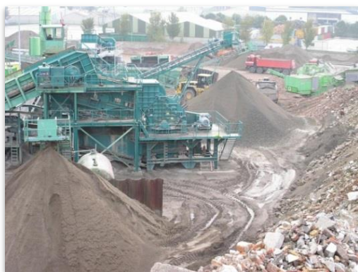
Postrojenje za recikliranje građevinskog otpada
