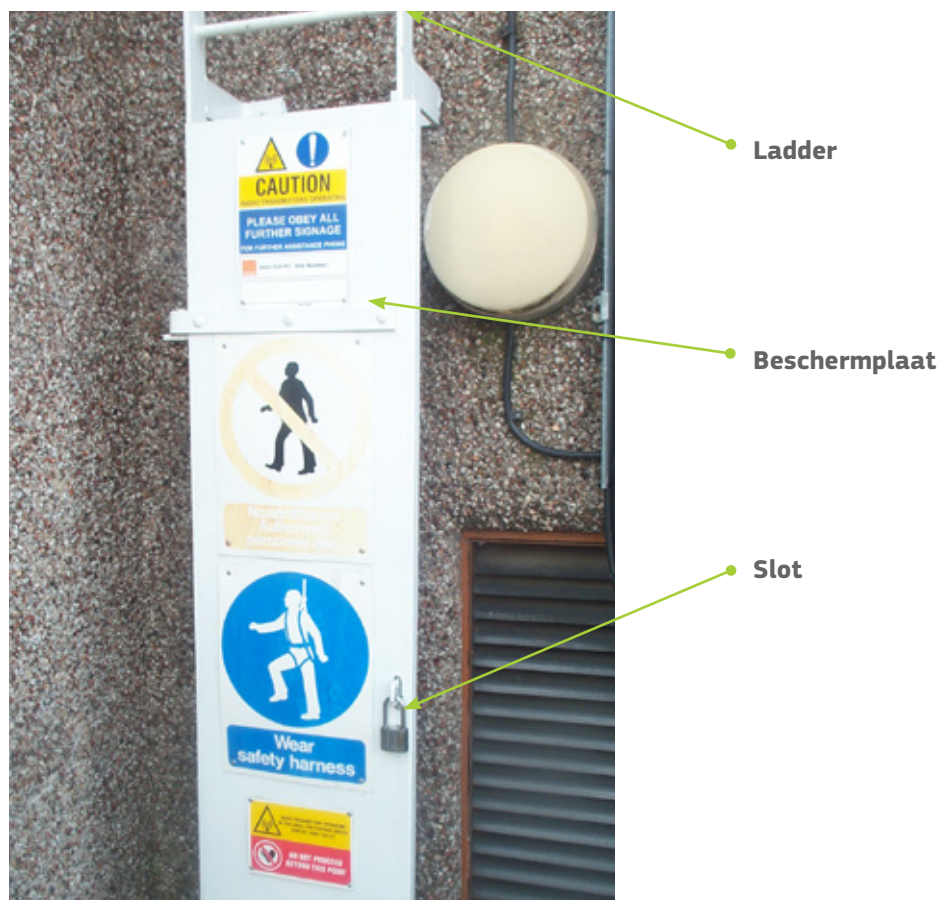
Figuur 9.2 — Gebruik van beschermplaat voor ladder om toegang tot sterke velden op een dak te beperken
