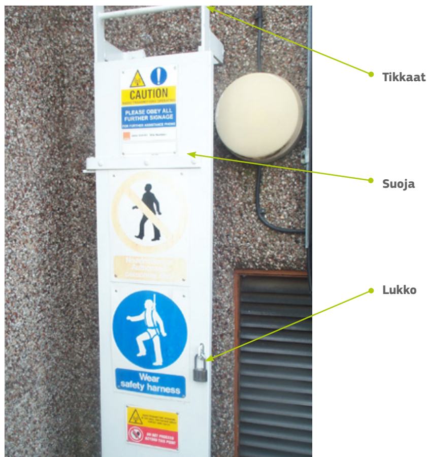
Kuva 9.2 Tikkaiden kiipeämissuoja, jolla rajoitetaan pääsyä kosketuksiin katolla olevien voimakkaiden kenttien kanssa
