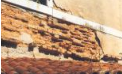
Venise : dommages causés par le sel à la brique et au plâtre.
