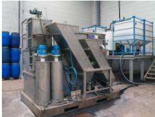
Planta de tratamiento de aguas residuales
