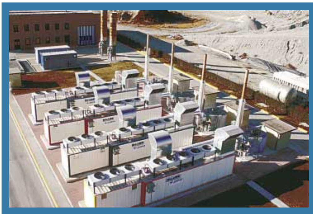
■ La centrale termoelettrica per il recupero energetico del biogas, con i quattro gruppi elettrogeni e, sullo sfondo, le due torce di combustione.
