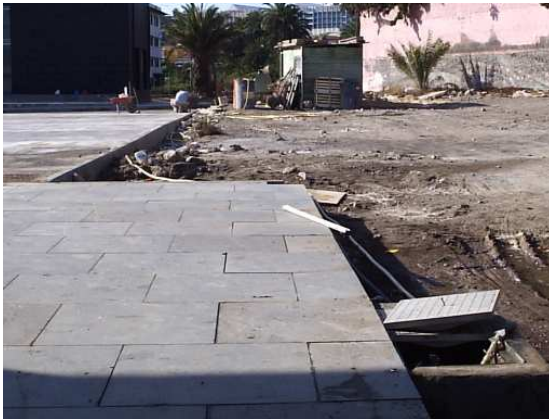
Detalle conexión manguera de agua
