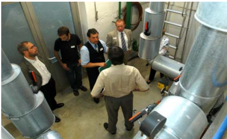
Öko-Audit: Besichtigung der Fernwärmanlage im Schulhaus. Fernwärme ist ein Abfallprodukt der Stromerzeugung im Rheinhafen-Dampfkraftwerk
