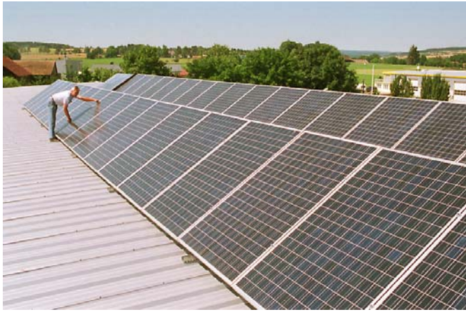
Photovoltaikanlage auf dem Bauhof
