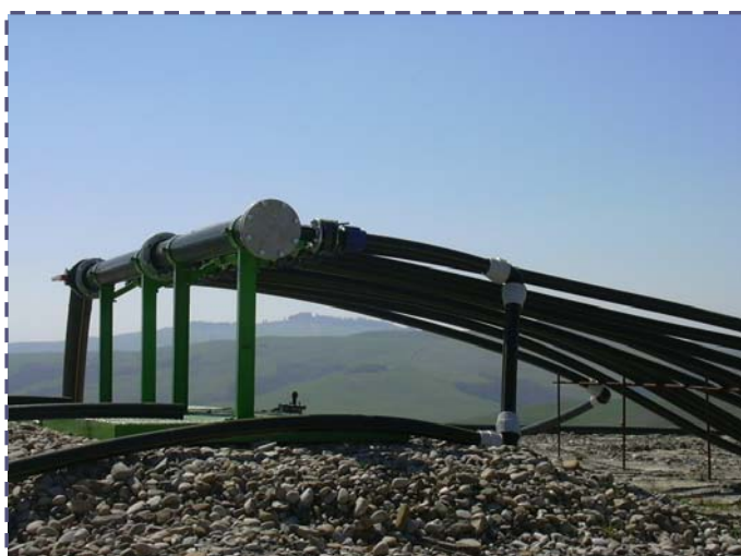
Figura 18. Impianto di captazione da biogas prodotto da discarica.
