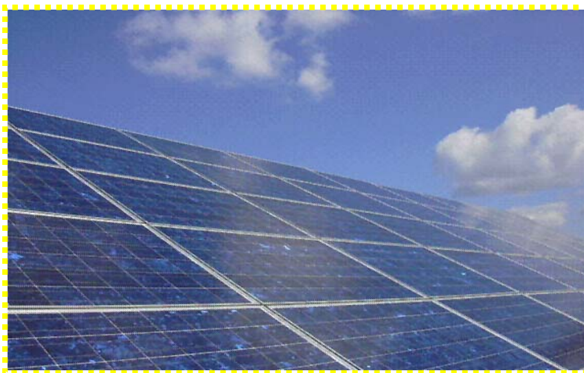
Figura 19. Impianto fotovoltaico installato presso il termovalorizzatore di Poggibonsi.
