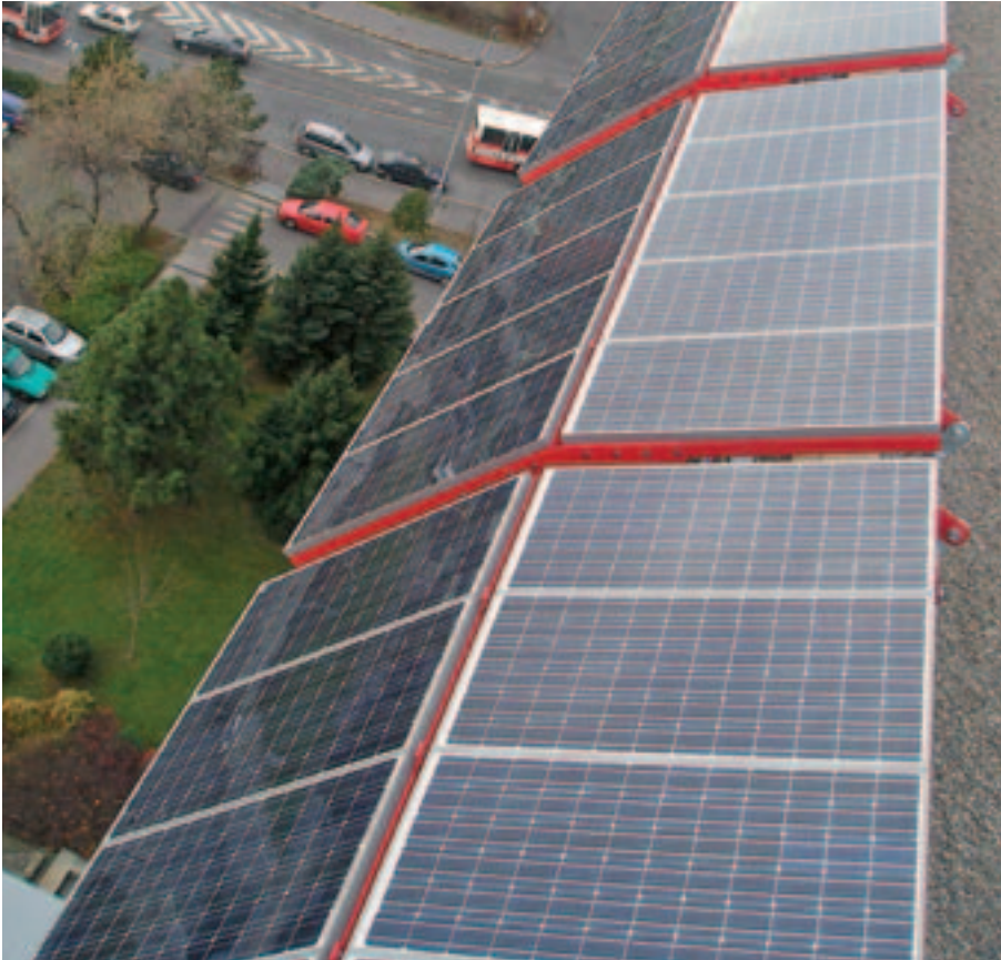
Obrázek 5 Fotovoltaická elektrárna na střeše budovy ministerstva
