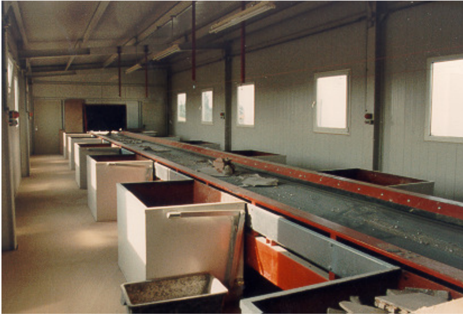
Abbildung: Sortierhaus mit Abwurfschächten
