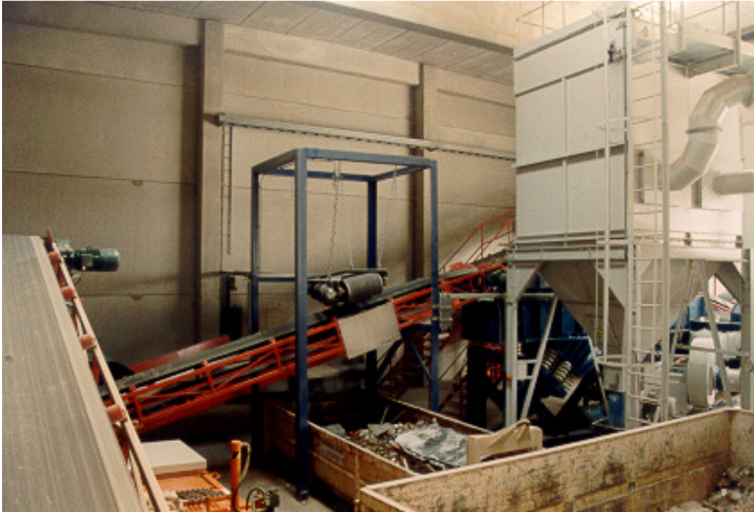
Abbildung: Überbandmagnetabscheider, Impulsluftfilter, dahinter Fingersieb (blau) und dazugehöriges Gebläse
