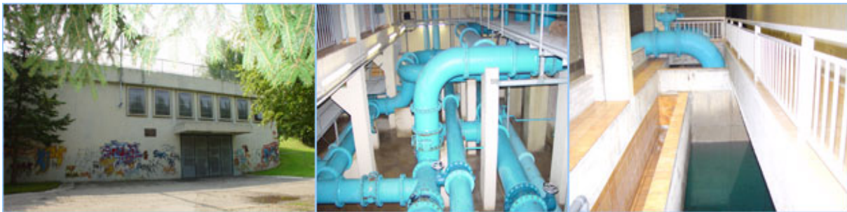
Hochbehälter, Rohrkeller, Behälterkammer Spitalberg (Quelle: Wassergewinnung)
