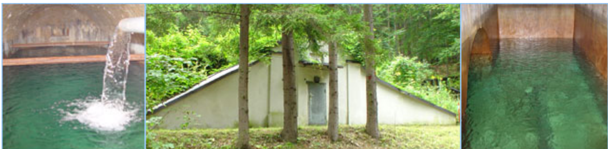
Hochbehälter Sattnitz (Quelle: Wassergewinnung)
