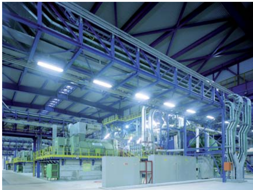
Vista della sala macchine – Gruppo turbogas-alternatore
