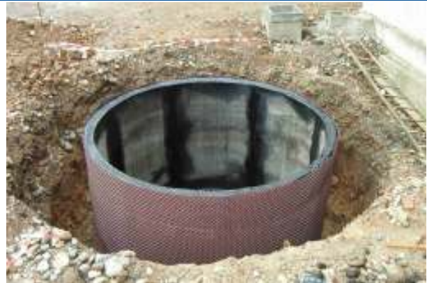
Figura 5.3 Dettaglio vasca stagna raccolta percolato pressa
