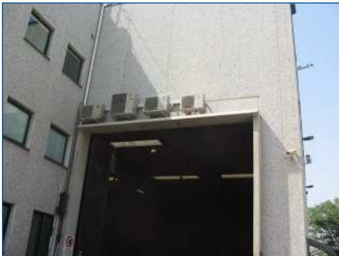
Figura 5.8 Posizionamento delle unità esterne dei climatizzatori
