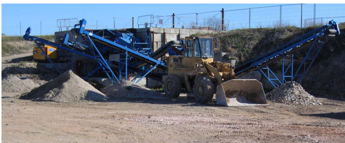
Fig.20 Vista generale dell'impianto (lotto 3)
