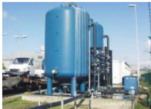
GW-Reinigungsanlage der Stadt Düsseldorf auf dem Werkgelände der DaimlerChrysler AG
