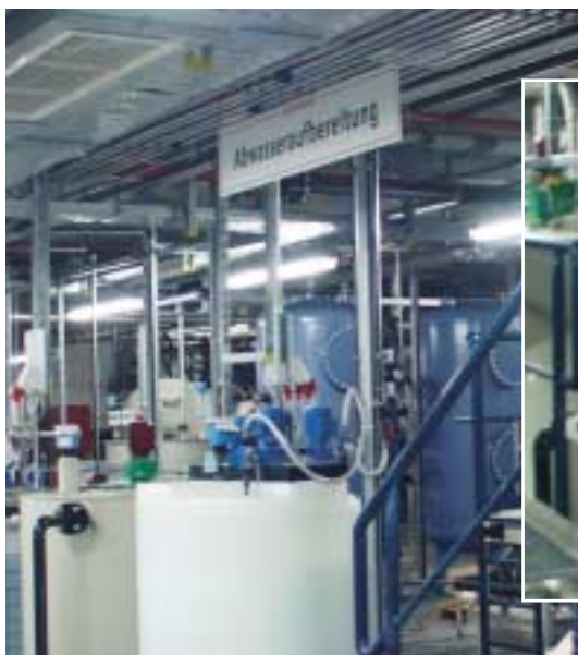
Neue Abwasseranlage (Lackierung 3. Baustufe) Chargenbehandlung für Abwässer aus der Fahrzeuglackierung
