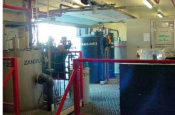
Waterzuiverings- installatie van Flextronics
