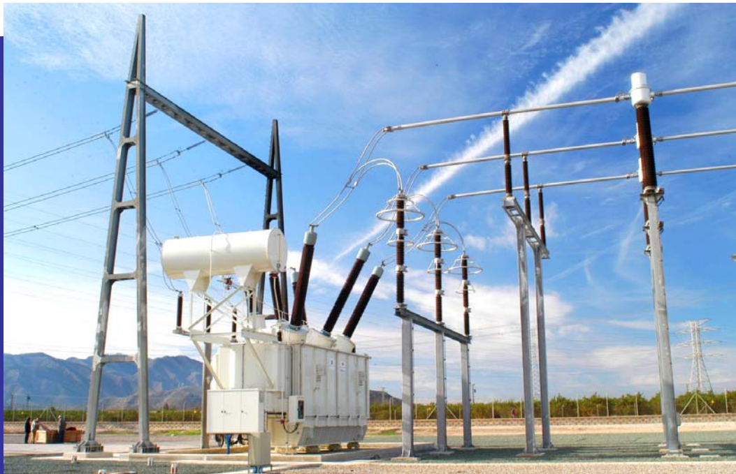
Transformador acorazado en funcionamiento
