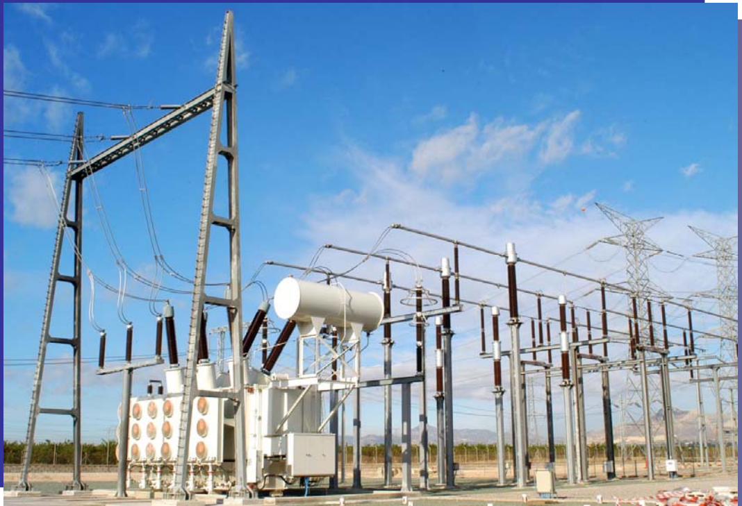
Politrafo de 450 MVA, 400 kV en servicio con la conexión 400/230 kV
