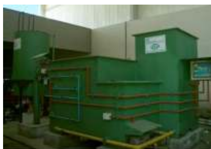
figura 8 - sistema de separação água / hidrocarbonetos instalado na Manutenção
