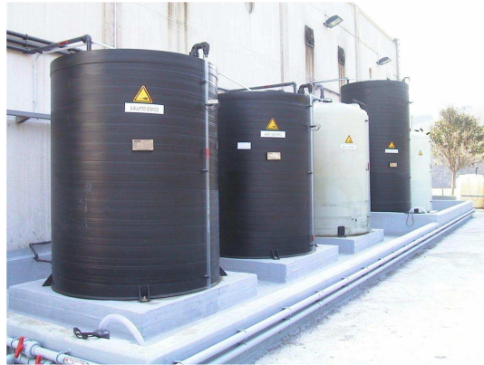
ALMACÉN DE PRODUCTOS QUÍMICOS
