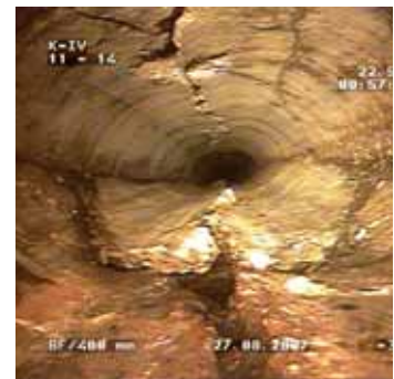
... und Brüche, die es zu sanieren gilt.
