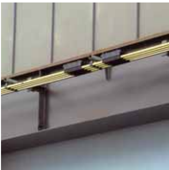
... und isolierte Schleifleitungen mit minimiertem Risiko eines Unfalles durch Stromschlag
