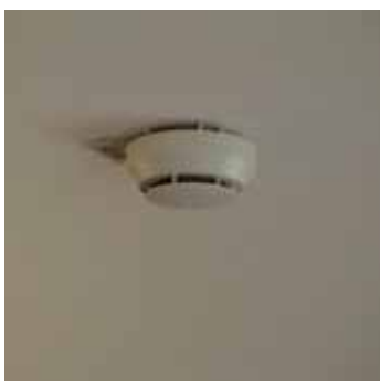
Typische Lösung für Büroräume und gering belastete und niedrige Fertigungshallen: Einzelmelder an der Decke.
