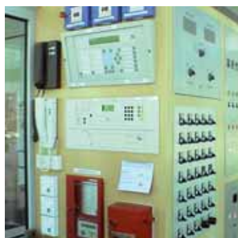
Feuermeldezentrale beim Portier der VAEE.
