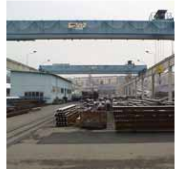
Beheizte Katzfahrschienen für Kräne am Schienenlagerplatz verringern Unfallrisiko im Winter
