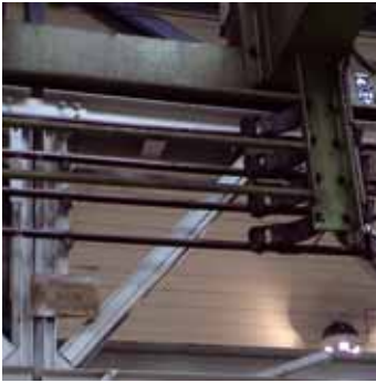
Offene Schleifleitungen mit Gefahren durch direkte oder indirekte Berührung...
