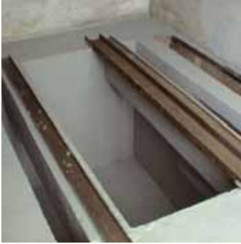
Öldichte Auffangwannen mit ausreichendem Volumen unter allen Transformatoren
