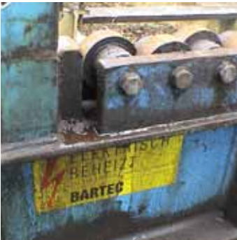
Detailaufnahme Heizband auf Rollenbahn
