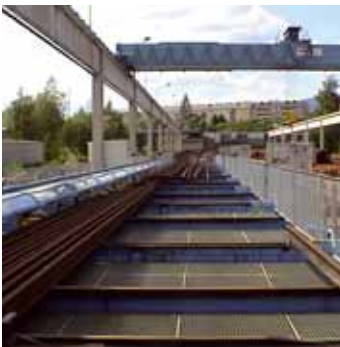
Schleusenregelung mit automatischer Zählfunktion beim Zuförderfeld der „Bohr-Sägeanlage“
