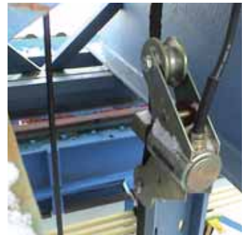
Überlastsicherungen an Brückenkränen...
