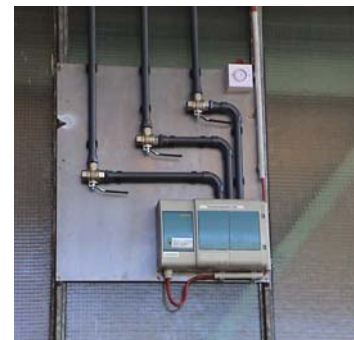
Der Zentraldetektor des Rauchansaugsystems mit den Ansaugrohren
