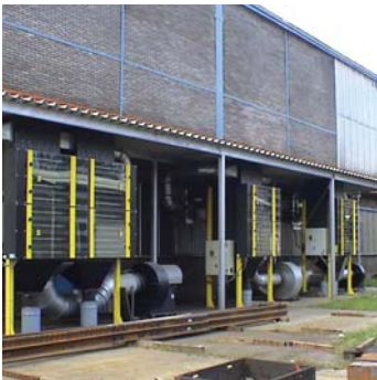
... und neue Filteranlagen
