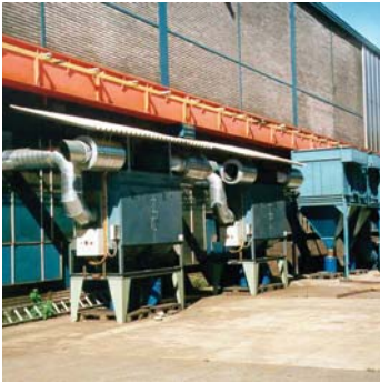
Altanlage für Herzschleiferkabinen 1-8...
