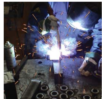
CO 2 Schweißen ohne Absaugung des Schweißrauches
