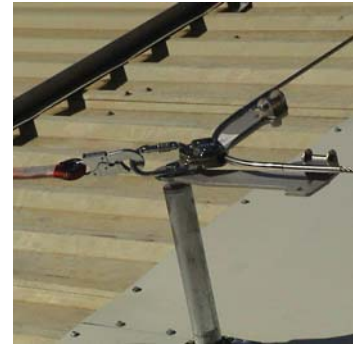
Das durchlaufende Seilsicherungssystem am Dach des BG 11, mit dem Seilgleiter.
