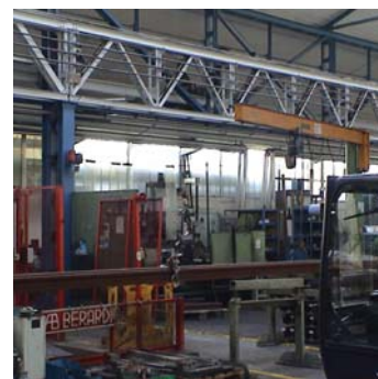
Die Drehleuchte im BG11 sorgt für zusätzl. Sicherheit in der Kommunikation zwischen Stapler und Kranfahrern um ev. Kollisionen vorzubeugen.
