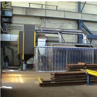
Neue Absaug/Filteranlage für Zungenschleiferkabinen 2006
