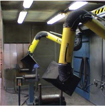
Zwei Absaugarme unterstützen die Stauberfassung in den Kabinen
