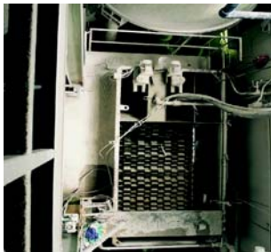
Foto 14 – Impianto di depurazione delle acque
