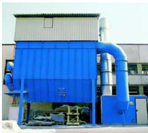
Foto 15 – Impianto di abbattimento delle polveri
