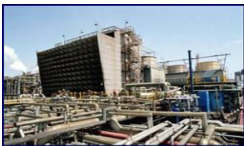
Figura 11: Torre de Refrigeración.
