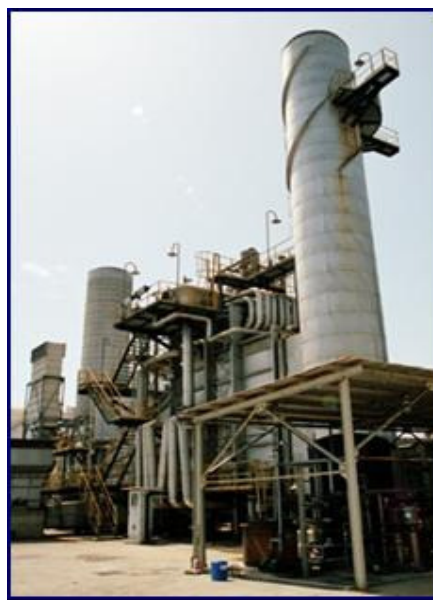
Figura 12: Turbina de cogeneración.
