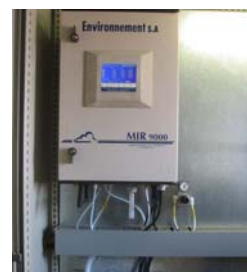
Analizador de gases
